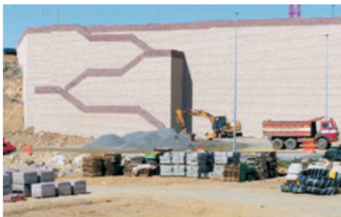
Rys. 2. Ściana oporowa z gruntu zbrojonego z licem z bloczków, system Rockwood (Hiszpania 2002 r., Huesker Synthetic GmbH)
