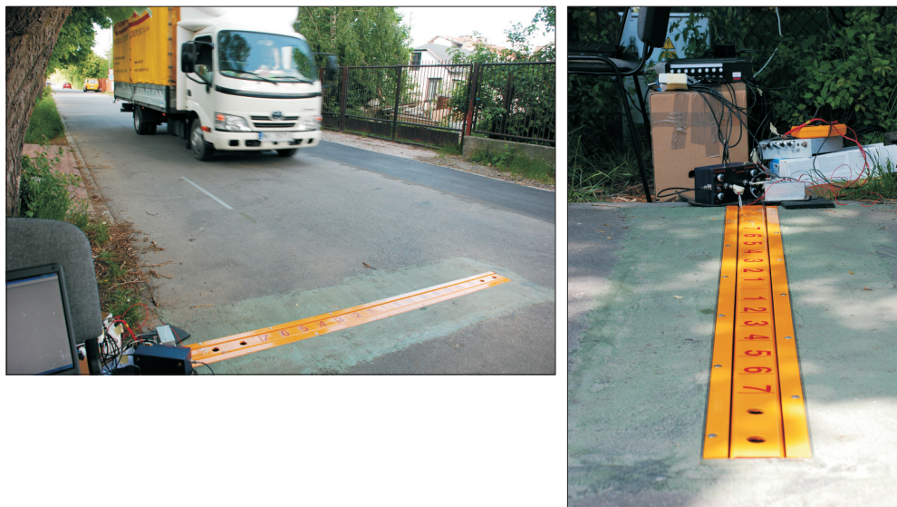
Rys. 15. Widok zainstalowanego urządzenia ważącego na drodze publicznej Fig. 15. New version of load detecting device mounted on public road
