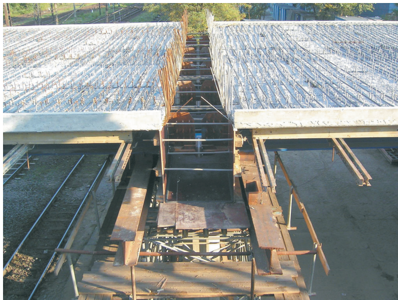
Rys.2. Budowa wiaduktu z dźwigarów VFT Fig.2. Construction of a viaduct made of VFT girders
