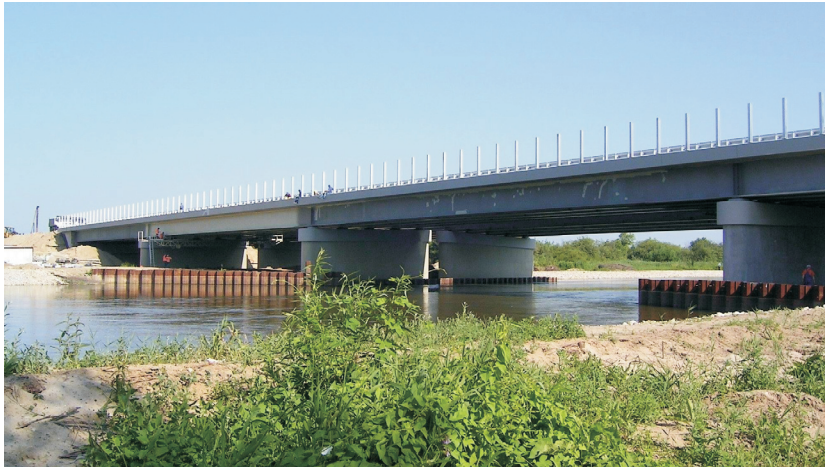
Rys.4. Widok ogólny mostu przez rzekę Wartę w ciągu autostrady A2 Fig.4. General view of the bridge over the Warta river, Motorway A2
