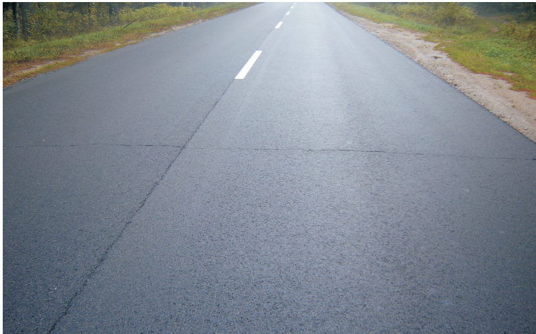
Rys.1. Spękania poprzeczne wywołane oddziaływaniem niskich temperatur Fig.1. Transverse cracking due to low temperature action
