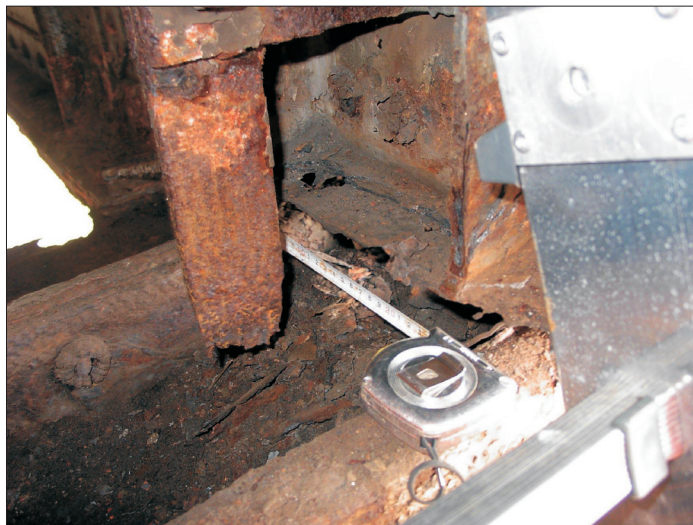
Rys.3. Awaria wiaduktu w ciągu ul. Braci Lewoniewskich w Gdańsku – skorodowane podwieszenie ściągu
