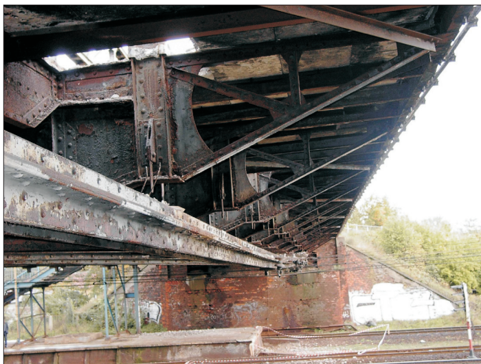
Rys.4. Awaria wiaduktu w ciągu ul. Braci Lewoniewskich w Gdańsku – widok opadniętego ściągu
