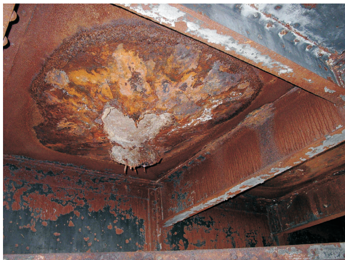
Rys.5. Korozja blachy nieckowej jezdni na wiadukcie w ciągu ul. Braci Lewoniewskich w Gdańsku
