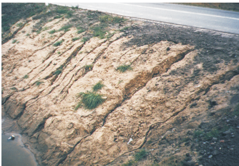
Rys.8. Przykłady niewłaściwego zabezpieczenia skarp nasypu obwodnicy drogowej w Radzyminie Fig.8. Examples of improper protection of the embankment scarps at by-pass road in Radzymin
