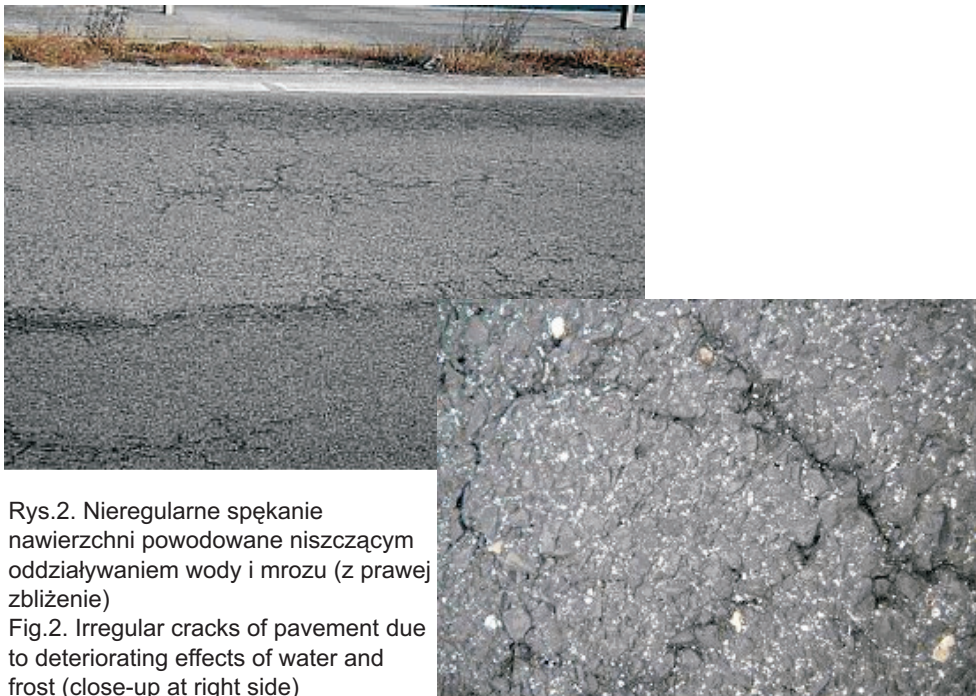
Rys.1. Zniszczenia powierzchniowe powodowane niszczącym oddziaływaniem wody i mrozu (z prawej zbliżenie) Fig.2. Surface distresses due to deteriorating effects of water and frost (close-up at right side)
