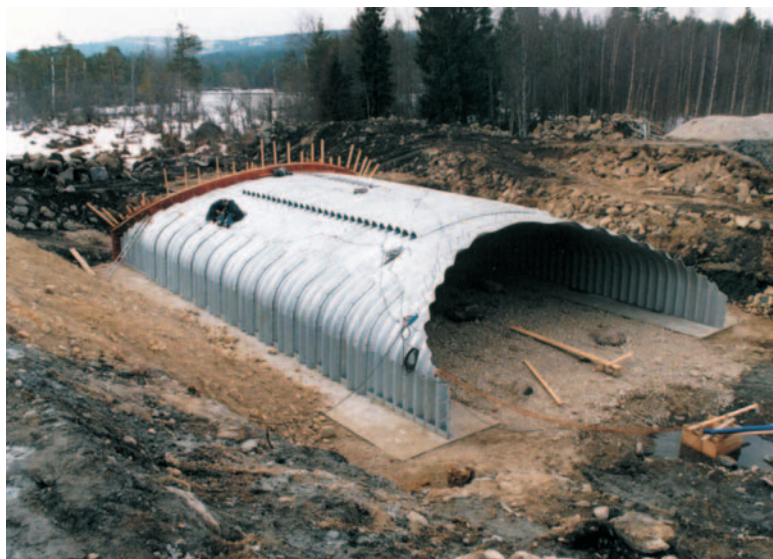
Rys.2. Widok z góry na zmontowaną stalową powłokę mostu podczas naklejania czujników tensometrycznych w przekroju I-I (klucz)
