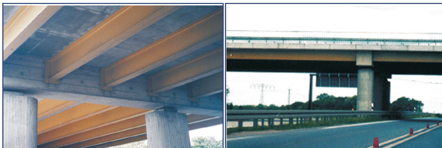
Rys.35. Ustrój nośny konstrukcji zespolonej, złożonej z walcowanych dźwigarów stalowych, połączonych z betonową poprzeczną podporową, wyraźnie dzielącą ustrój nośny na przęsła (fot. G. Łagoda)
