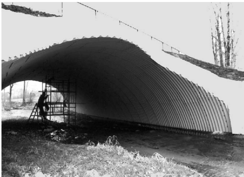
Rys.7. Widok do wnętrza stalowej konstrukcji obiektu wraz z umieszczonymi na rusztowaniach czujnikami przemieszczeń Fig.7. Inside view of the steel structure and the stand supporting dial gauges
