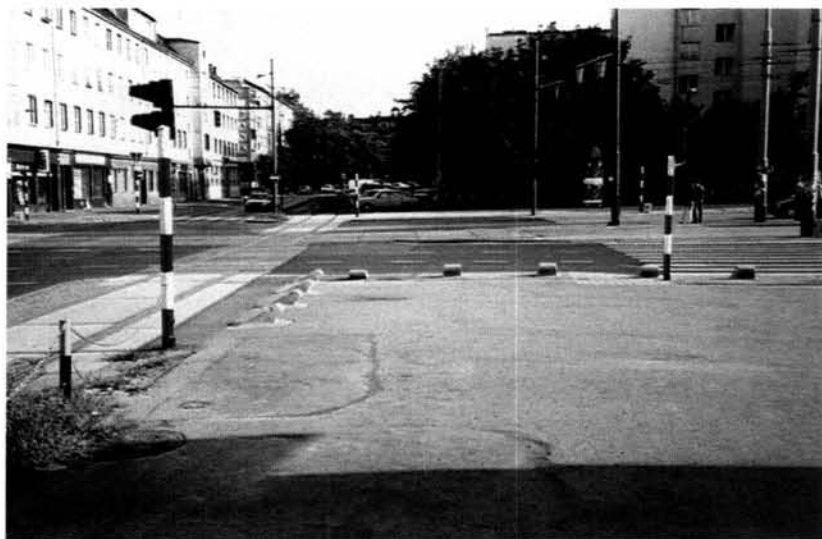
Rys.5. Czy takie wyгородzenie drogi dla pieszych jest dobrym rozwiązaniem? Wrocław Fig.5. Is such fencing of pedestrian route a good solution? Wrocław
