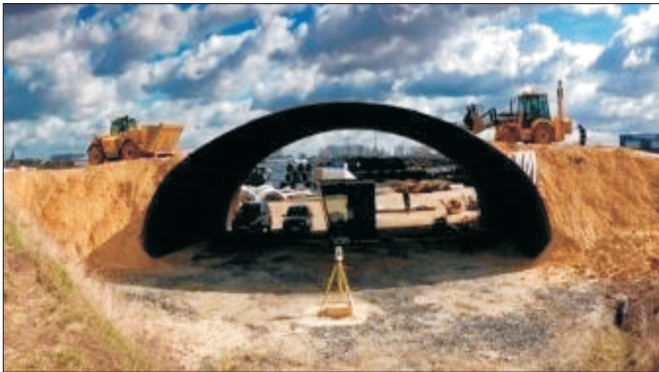
Rys. 1. View of investigated structure during its construction Rys. 1. Widok badanego obiektu podczas budowy
