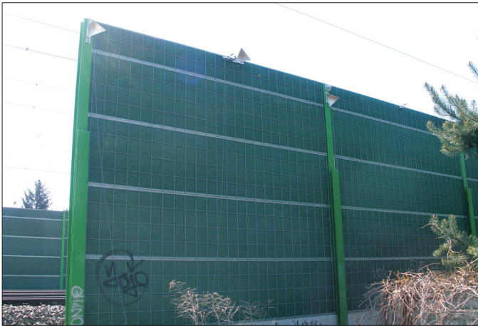
Fig. 6. The second investigated section: from the left (direction of incoming trains) the tested span no. 01-02 (with accelerometers and interferometric radar reflectors installed on the top of the columns and the panel) and the tested span no. 02-03 (with installed accelerometers) Rys. 6. Drugi badany odcinek: od lewej (kierunku najazdu pociągów) badane przęsło nr 01-02 (z zainstalowanymi na górze słupów i panelu reflektorami do radaru interferencyjnego i akcelerometrami) oraz badane przęsło 02-03 (z zainstalowanymi akcelerometrami)
