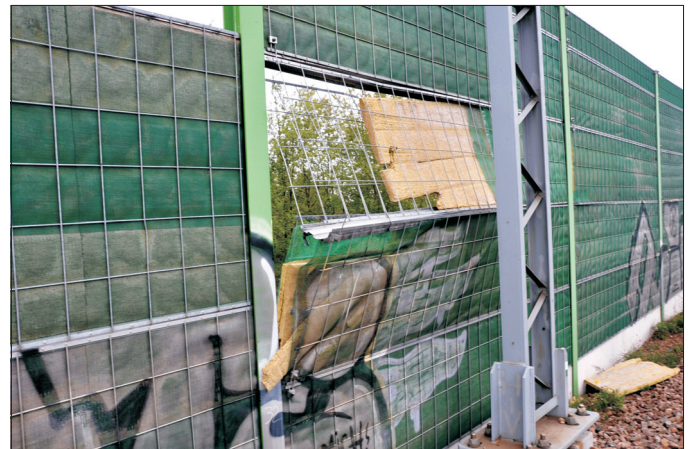
Fig. 1. Panels falling out of the barrier Rys. 1. Panele wypadające z ekranu
