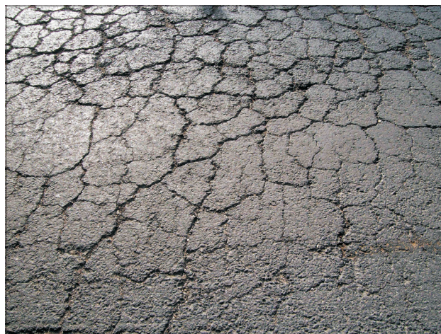
Fig. 2. Cracks visible on the surface of asphalt pavement Rys. 2. Spękania widoczne na nawierzchni asfaltowej
