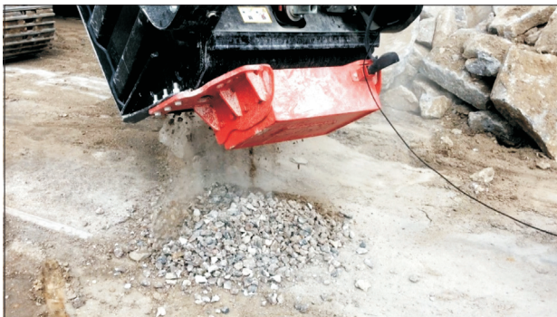
Fig. 2. Recycled concrete aggregate obtained by crushing slabs Rys. 2. Kruszywo betonowe uzyskane z przekruszenia płyt
