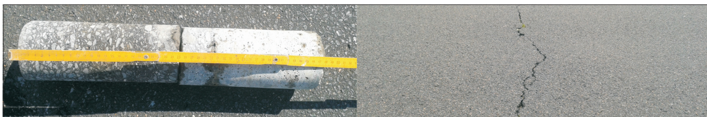
Fig. 1. Reflection cracks in asphalt layers 24 cm thick Rys. 1. Spękanie odbite w warstwach asfaltowych o grubości 24 cm
