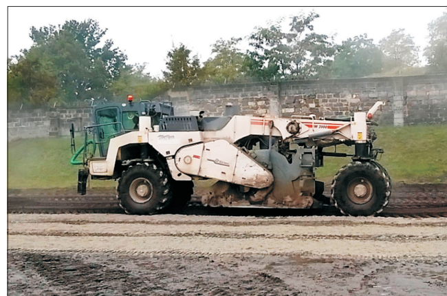
Fig. 6. Recycler executing cement bound mixture layer on site Rys. 6. Widok recyklera wykonującego warstwę mieszanki związanej cementowej w technologii na miejscu
