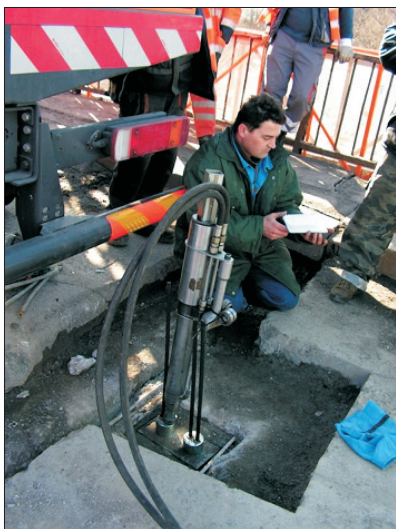
Fig. 10. Strand prestressing using tool PAUL Rys. 10. Naciąg cięgien przy użyciu prasy PAUL
