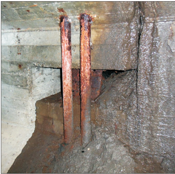
Fig. 4. View at the original cables Rys. 4. Widok oryginalnie założonych kabli sprężających
