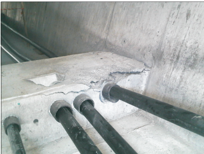
Fig. 13. View of the damaged part of the C-C deviator directly after failure Rys. 13. Widok zniszczonego fragmentu dewiatora C-C bezpośrednio po awarii
