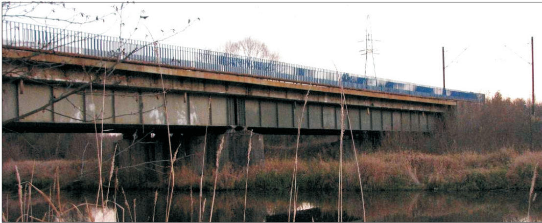
Fig. 1. Overview of the bridge over Czarna river, located on the CMK trunk line at km 113+449 Rys. 1. Widok ogólny mostu nad rzeką Czarną zlokalizowany w km 113+449 CMK
