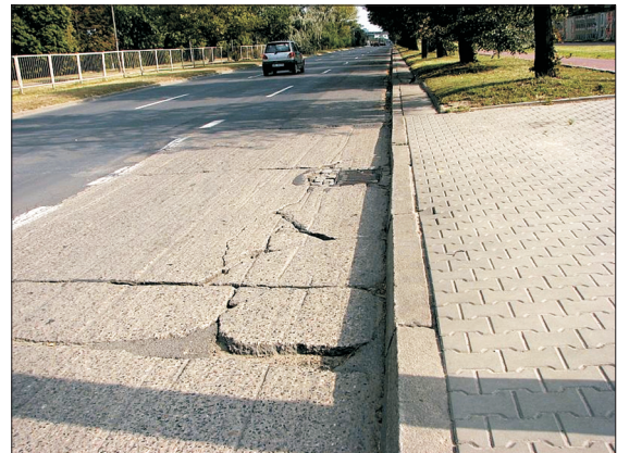
Fig. 2. Heavily cracked slabs with large losses Rys. 2. Mocno spękane płyty wraz z dużymi ubytkami
