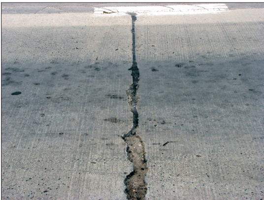
Fig. 1. Spalling at slabs edges Rys. 1. Wykruszenia na brzegach płyt
