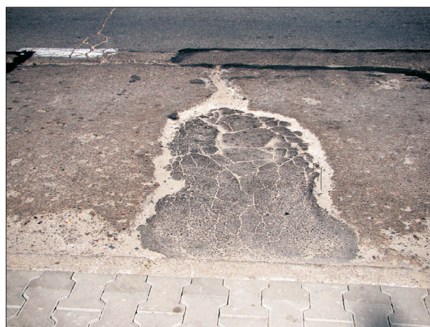
Fig. 4. Heavily damaged pavement with very large losses Rys. 4. Mocno zdegradowana nawierzchnia z bardzo dużymi ubytkami części płyt
