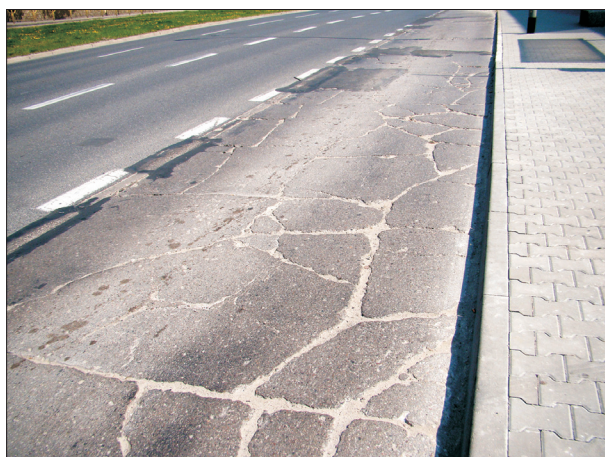
Fig. 3. Heavily damaged pavement Rys. 3. Mocno zdegradowana nawierzchnia
