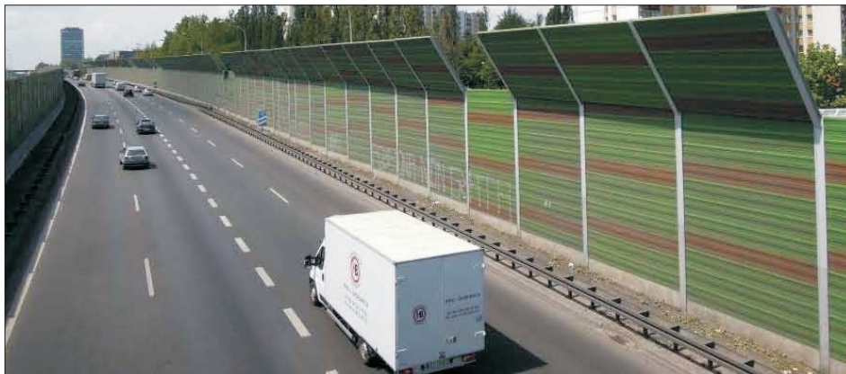
Fig. 1. View of the 8.5 m high barrier Rys. 1. Widok ekranu o wysokości 8,5 m
