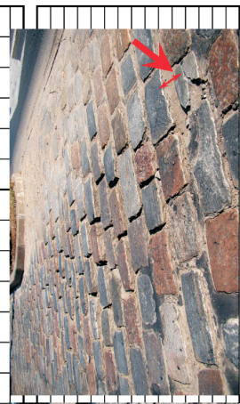
Maksymalna szerokość wykruszenia krawędzi pęknięć
