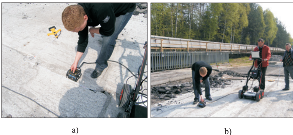
Rys. 3. Widok na wykonywanie skanów belki mostowej: a) poprzecznych (T), b) podłużnych (L) Fig. 3. View on executed scans of the bridge beam: a) transverse (T), b) longitudinal (L)
