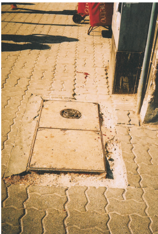
Fot. 17. Błędna instalacja zwiercenia powyżej poziomu chodnika; na skutek potknięcia został uszkodzony pieszy, widoczne ślady krwi
