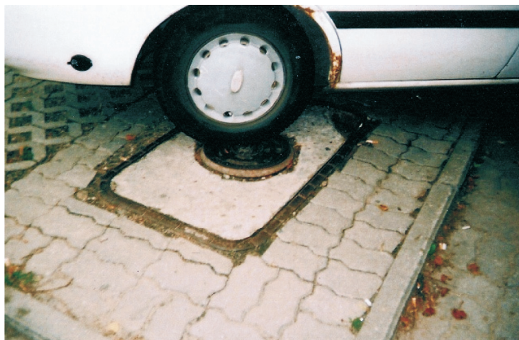
Fot. 10. Pokrywa żelbetowa o wym. 997 × 597 × 80 mm – widoczny wietrznik luźno osadzony w otworze
