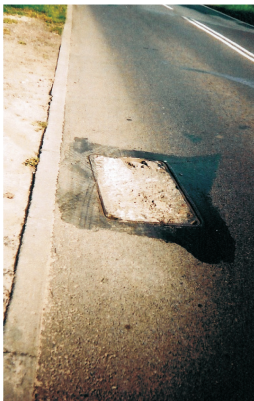
Fot. 13. Pokrywa żelbetowa zainstalowana pasie ruchu kołowego kategorii KR2; widoczny duży luz całkowity
