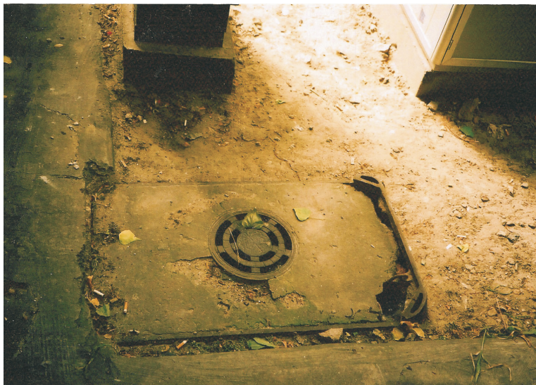
Fot. 16. Bardzo duże ubytki betonu w pokrywie i uszkodzenia żeliwnej oprawy
