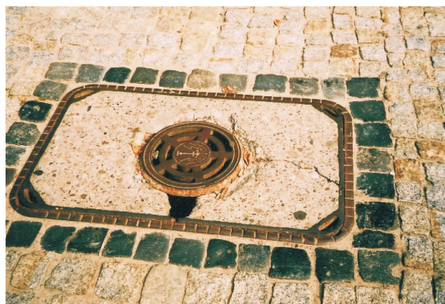
Fot. 8. Uszkodzona pokrywa ciężka; widoczne wyraźne ubytki betonu, pęknięcia betonu przez całą grubość pokrywy, brak przyczepności betonu do żeliwnego wietrznika, brak identyfikatora producenta oraz klasy wytrzymałości i innych
