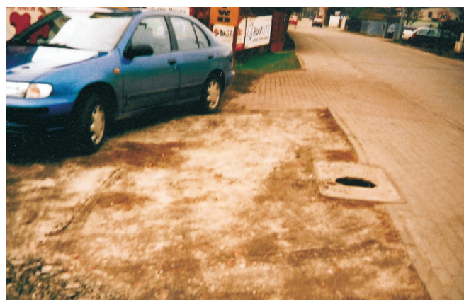
Fot. 9. Pokrywa żelbetowa o wym. 997 \times 597 \times 80 mm; widoczny brak wietrznika, pokrywa zlokalizowana w pasie jezdni o kategorii ruchu KR1
