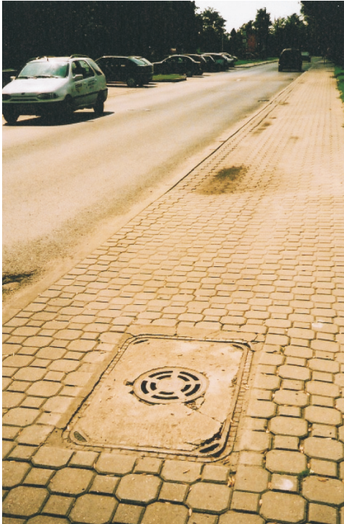
Fot. 5. Uszkodzona żelbetowa pokrywa z wietrznikiem \phi 330 mm; widoczne pęknięcia i ubytki betonu na całej grubości pokrywy
