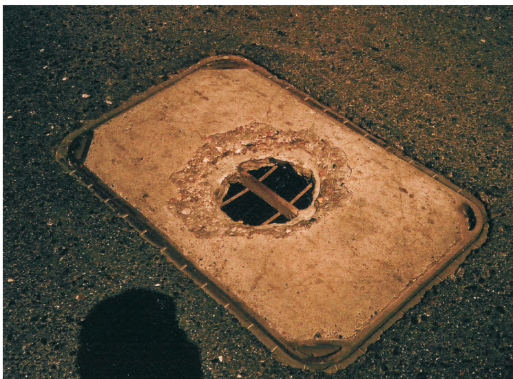
Rys. 1. Widok prefabrykowanej betonowej pokrywy studni kablowej zainstalowanej w jezdni kategorii ruchu KR4 w śródmieściu Warszawy – widoczny brak wietrznika oraz duże ubytki betonu (fot. Z. Czagowiec)
