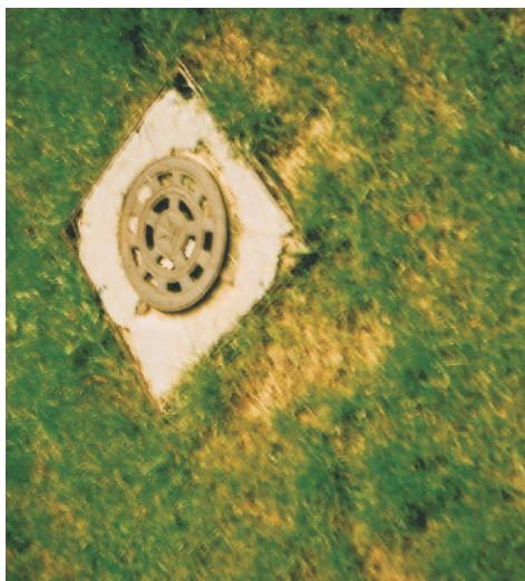
Fot. 14. Nieprawidłowy typ wietrznika i brak umocowania do pokrywy
