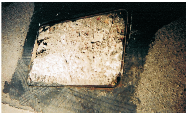
Fot. 12. Pokrywa żelbetowa zainstalowana w pasie ruchu kołowego kategorii KR2; widoczne bardzo duże ubytki betonu
