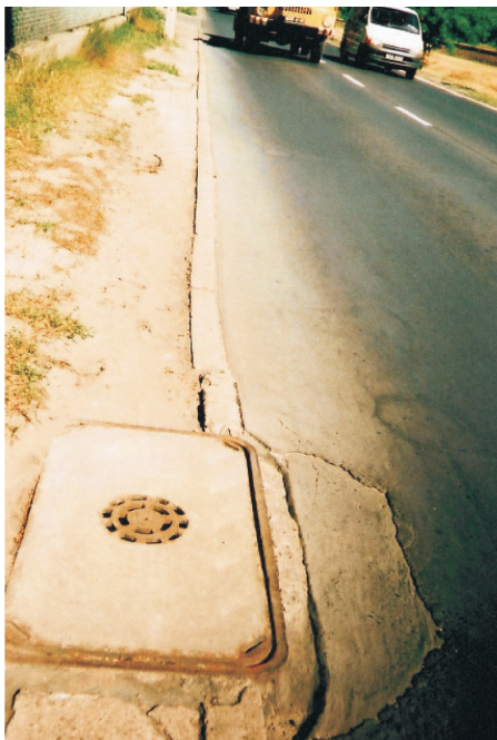
Fot. 3. Żelbetowa pokrywa z oprawą żeliwną w zwieńczeniu studni w pasie jezdni o kategorii ruchu KR2 – widoczne pęknięcia, zarwania fragmentu pasa jezdni oraz duże luzy od 15 do 20 mm pomiędzy ramą żeliwną zwieńczenia i oprawą żeliwną pokrywy; brak jakichkolwiek oznaczeń pokrywy oraz znaku budowlanego
