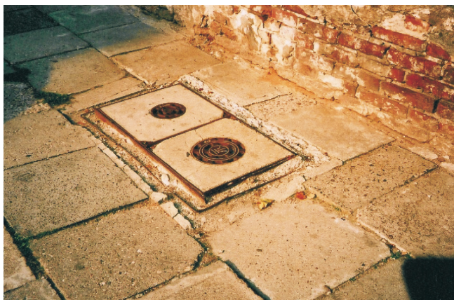
Fot. 7. Uszkodzone spękałe pokrywy w oprawie w uszkodzonym zwieńczeniu
