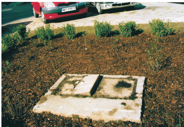
Rys. 19. Pokrywa zainstalowana w pasie zieleni, wielkość pokrywy niedostosowana do zwieńczenia
