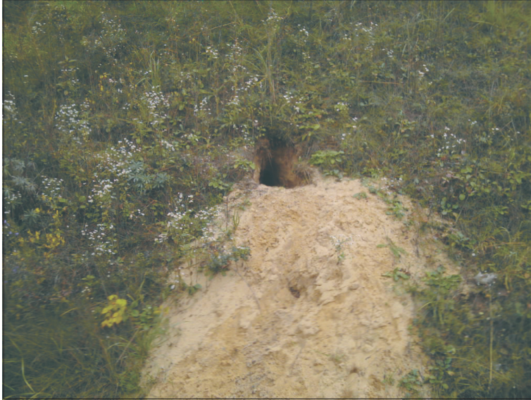
Rys. 8. Niedostateczne zagęszczenie skarpy sprzyja powstawaniu nor dzikich zwierząt, co ma niekorzystny wpływ na stateczność skarpy
