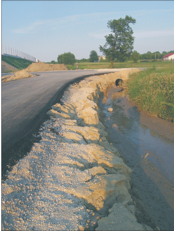
Rys. 7. Zerodowane pobocze. Brak tymczasowych krawężników do odprowadzania wód opadowych z jezdni
