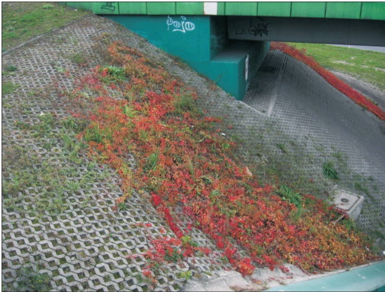
Rys. 11. Ubezpieczenie skarpy ażurowymi płytami betonowymi Fig. 11. Slope reinforcement with openwork concrete plates
