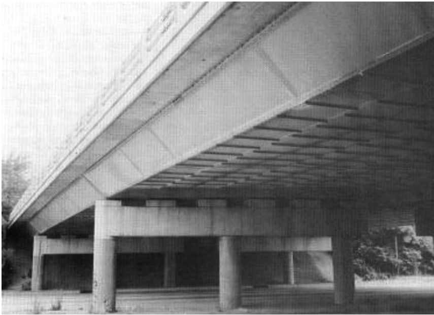
Rys.8. Wiadukt systemu Fairchild nad autostradą Sunrise Highway na Long Island w Nowym Jorku
